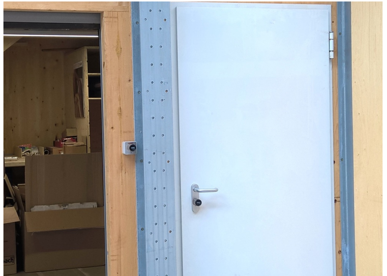
Sensible Bereiche vor nicht authentifiziertem Zutritt schützen: Sicherer Zutritt durch Tür und Tor
